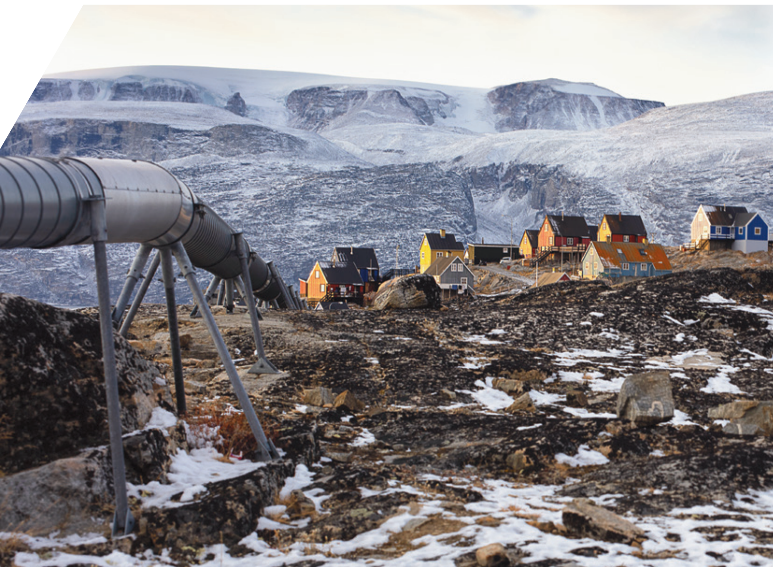
Råvandsforsyning til Uummannaq
